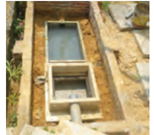
土中に埋設された新浄化装置
