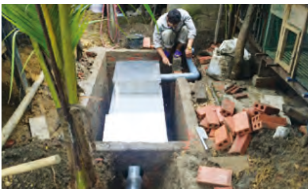
新浄化装置の設置
