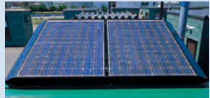
■ソーラー発電用パネル
